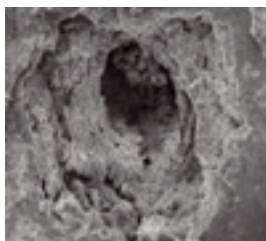
Immagine 5. Foro di corrosione
